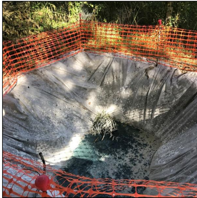
Figure 11 : Exemple d'un bassin de décantation provisoire pour les eaux d'exhaure de batardeaux
