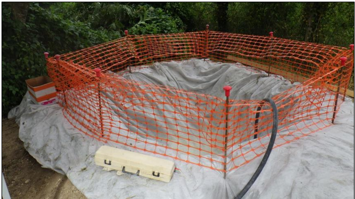
Figure 10 : Exemple d'un bassin de décantation provisoire pour les eaux d'exhaure de batardeaux
